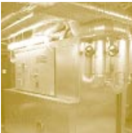
Solarstrom und Sanierung der Lüftungsanlage - zwei von zahlreichen Energieeinsparmaßnahmen in der Europaschule Köln.
